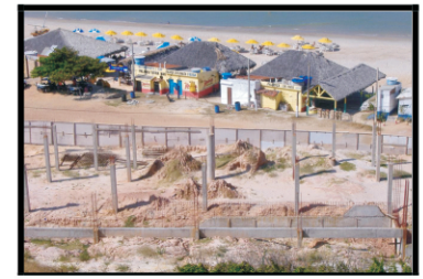
Figura 08: ocupação na pós-praia /praia de Morro Branco. Observa-se uma construção que vai ser um hotel. O local está fora da área que abrange os Monumentos Naturais
